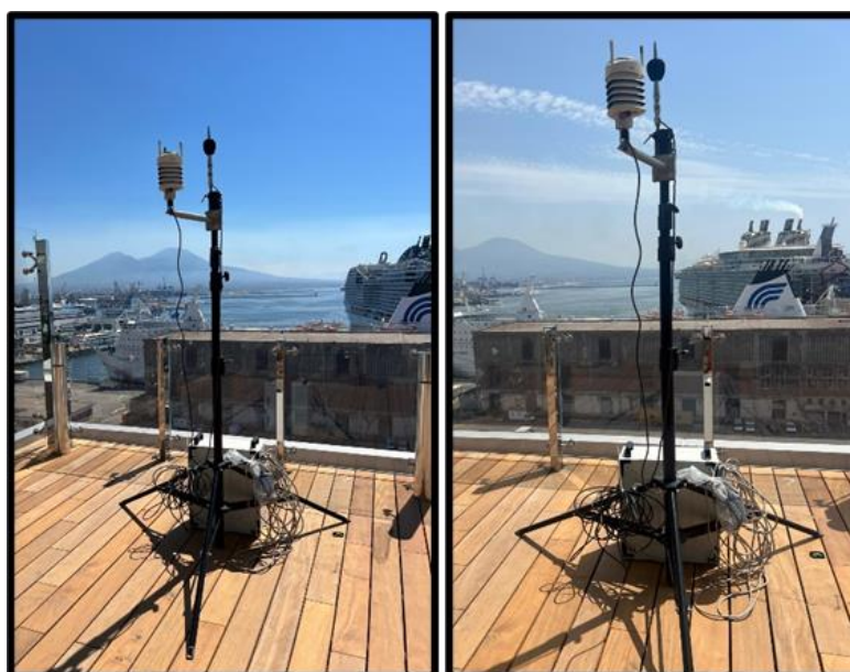
Centralina Monitoraggio Fusion 01 dB installata sul Terrazzo dell'Hotel Romeo sito in Via Colombo n.45
