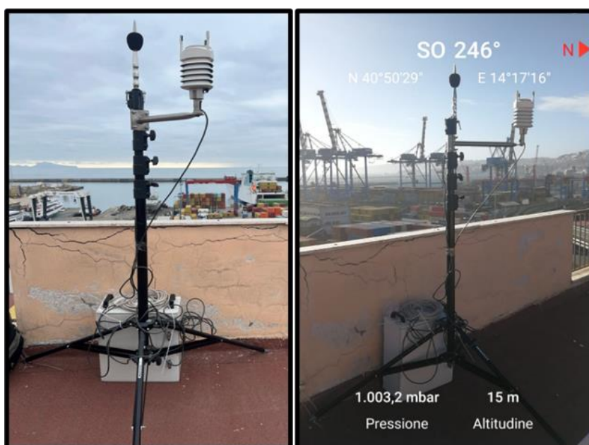
Centralina Monitoraggio Fusion 01 dB installata sul Terrazzo Edificio Condominio in Via Ponte dei Granili, 57
